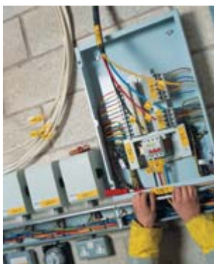
Laminiertes Flexi-Tape für Kabel- und Rohrmarkierungen. Geeignet zum Umkleben von engen Radien als Fähnchen oder Manschette.
